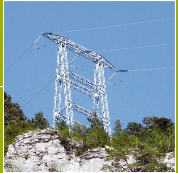
Tendido eléctrico. Parque Nacional de Ordesa Foto: Josechu Ferreras Tomé
